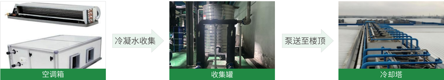
义安立讯开展空调冷凝水回收
